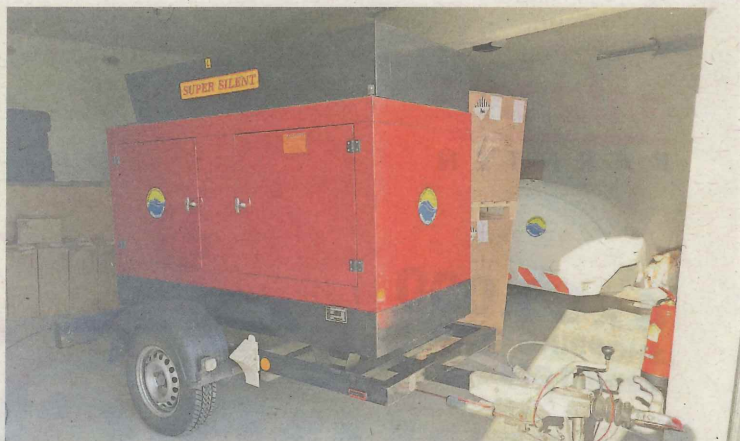
Eines der Notstromaggregate beim Wasserverband Millstätter See. Auch hier rüstet man stetig auf.
