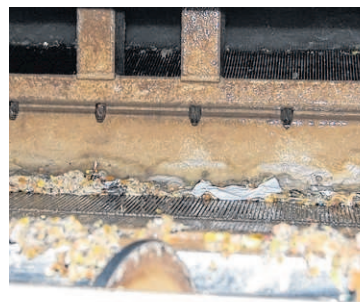
1. Schritt: Das hereinkommende Wasser kommt in die Rechenanlage. Alles, was größer als drei Millimeter ist, wird hier bereits entfernt
