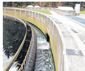
Hier wird das gereinigte Wasser aus der Kläranlage ausgeleitet. Die Sichttiefe in dem Becken beläuft sich auf etwa zwei Meter
