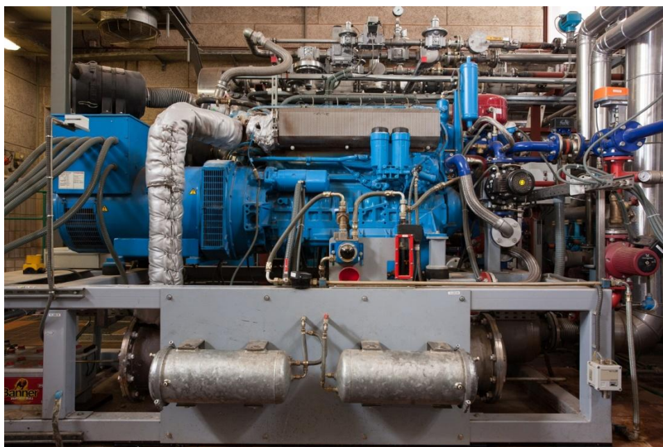
Bild: 190 kW Blockheizkraftwerk
