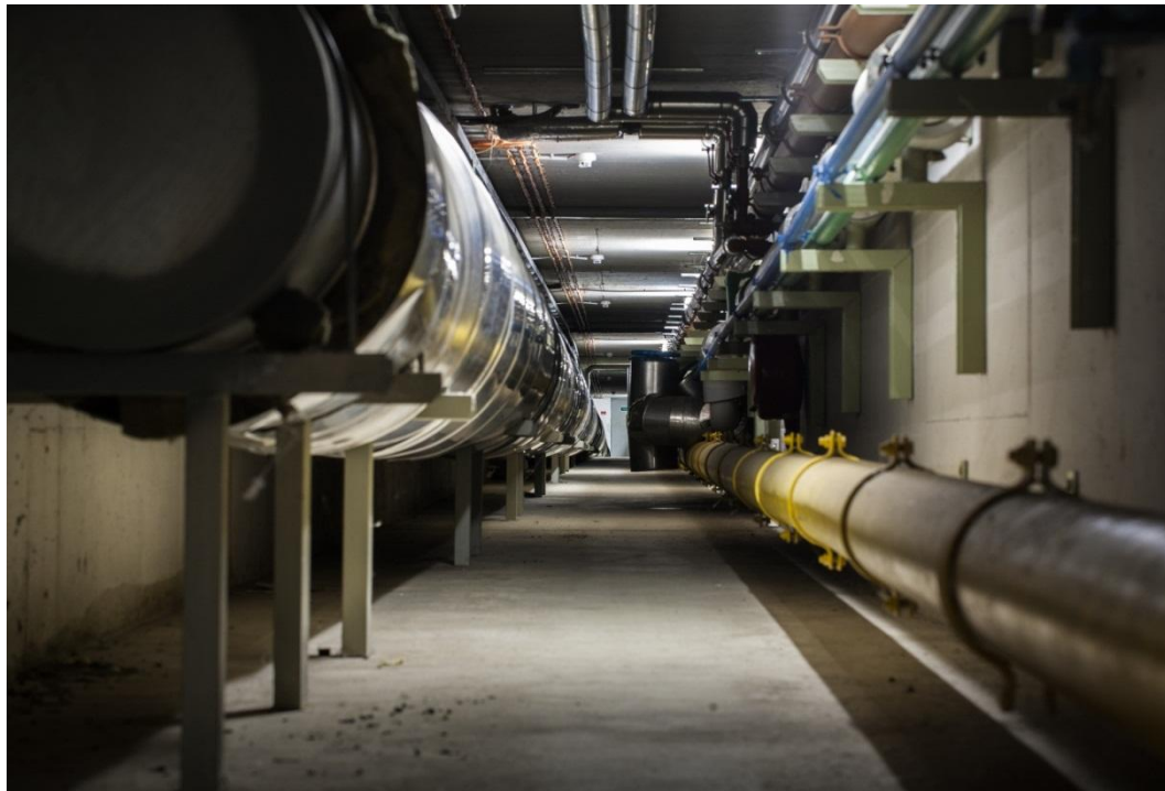
Bild: Kollektorgang - Rohrkeller
